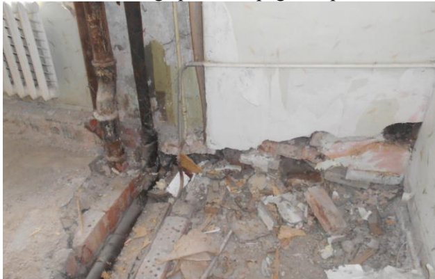
Att.Nr.6 - Nozīmīga plaisa no dzīvokļa Ģimnāzijas 25-6a puses
