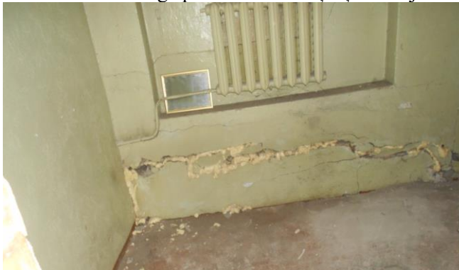
Att.Nr.7 - Nozīmīga plaisa no dzīvokļa Ģimnāzijas 25-6a puses
