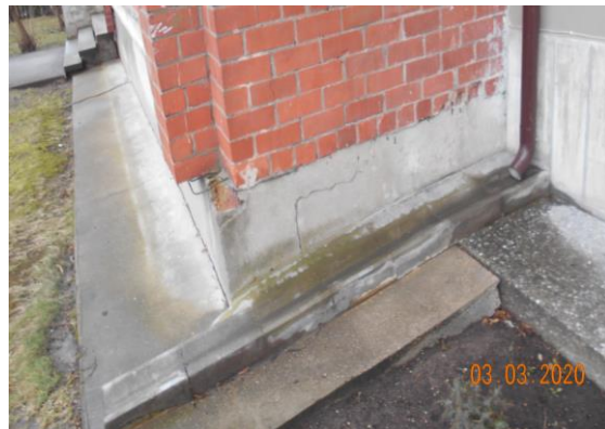
Att.Nr 4. Esošā notekcaurule ar betona tekni uz aizsargapmales
