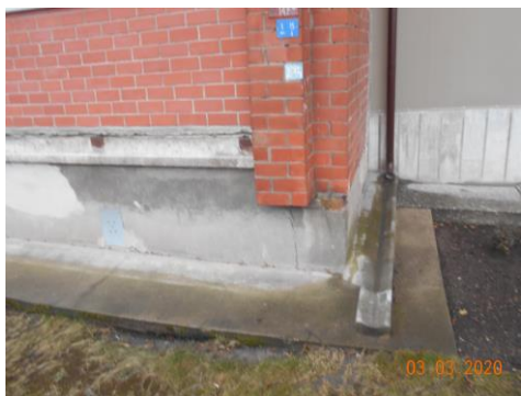
Att.Nr 5. Esošā notekcaurule ar betona tekni uz aizsargapmales
