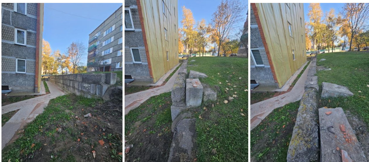
Foto 3.4.1. – 3.4.3. Blakus esošās teritorijas – Andreja Pumpura ielā 30, Daugavpilī, atbalstsiena
