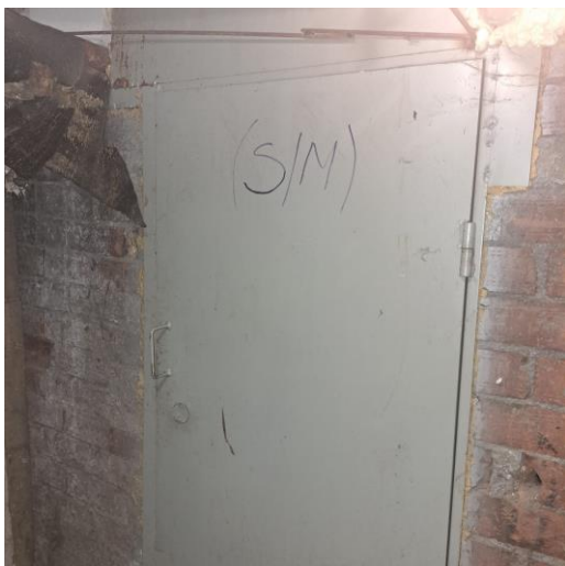
Foto 4.13.2. Iekšdurvis uz siltummezglu
